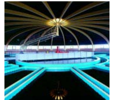
Ästhetik eines Wasserwerks. In Anlagen wie dieser von RWE in Mülheim wird Trinkwasser geklärt, bevor es in die Haushalte fließt
